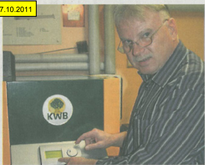
Die Bedienung einer Biomasse-Heizungsanlage ist denkbar einfach.
